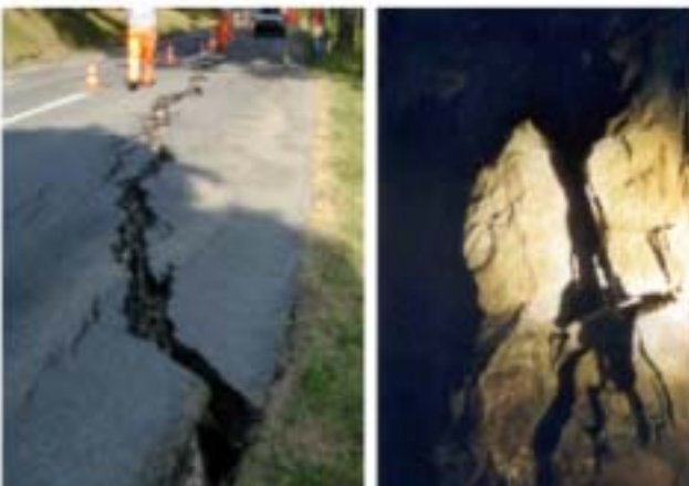
à gauche: dégâts constatés sur la route à droite: vue d'un pilier à l'intérieur des mines
